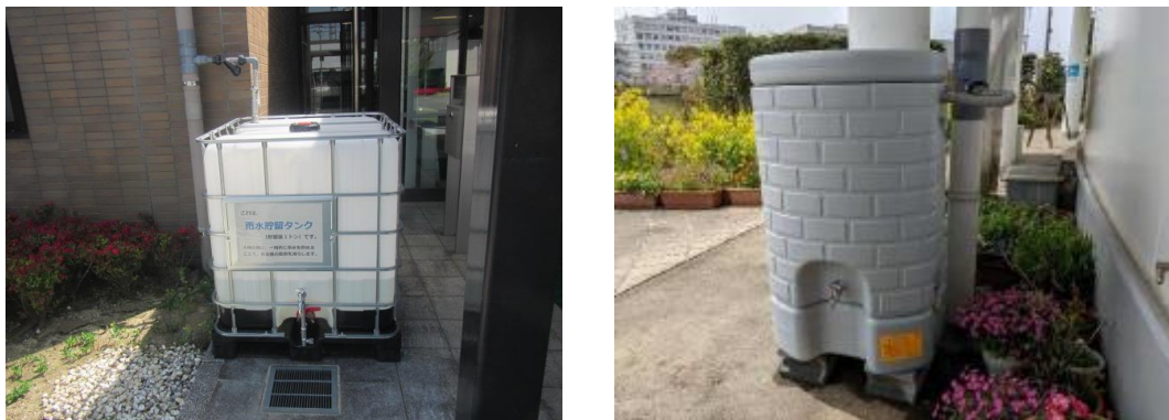
写真 4- 11 公共施設への雨水貯留タンク設置状況
