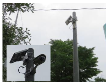
簡易監視カメラ設置(例)
